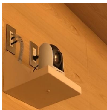
8. 館内モニターシステム (大ホール内カメラ)
